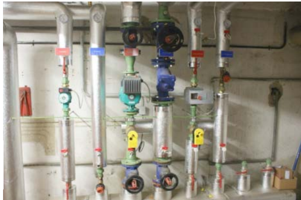
Kuva 18: Lämmönjako ja integroitu säätöjärjestelmä; AEE INTEC
