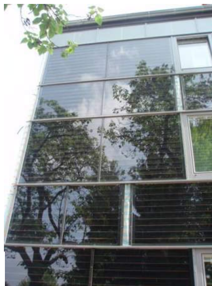
Kuva 18: Aurinkokerääjät julkisivussa Dieselweg, Graz; AEE INTEC
